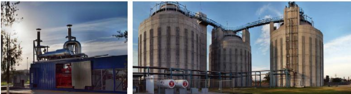
Figura 4-145. Biodigestores e intercambiadores de calor del sistema de cogeneración
