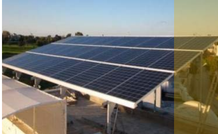
Image 2: Installation PV réalisée par la société WS.Energy (Source: WS.Energy)
