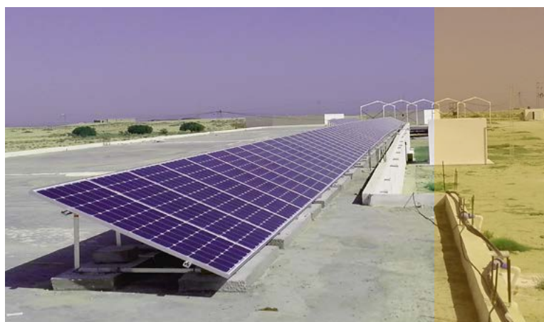
Image 4: Installation PV en cours de réalisation par la société d'installation Volta PV (Source: Volta PV)
