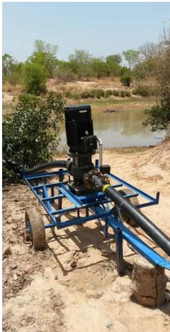
Pompe de surface sur structure mobile (Source : Lennart Woltering)
