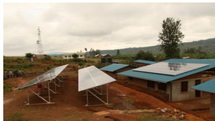
30 kWp Solar-Back-up für Berufsschule, Ruanda
