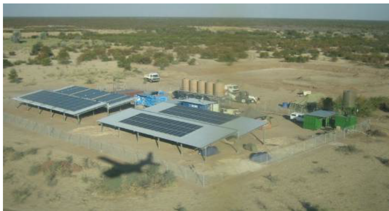
2 x 20kWp Solarsystem für Entsaltungsanlagen. Namibia
