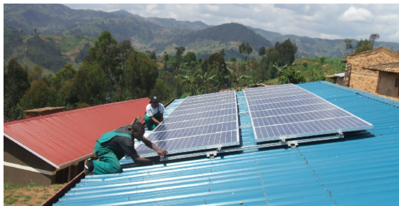
4 kWp Stromversorgung für Schule, Ruanda
